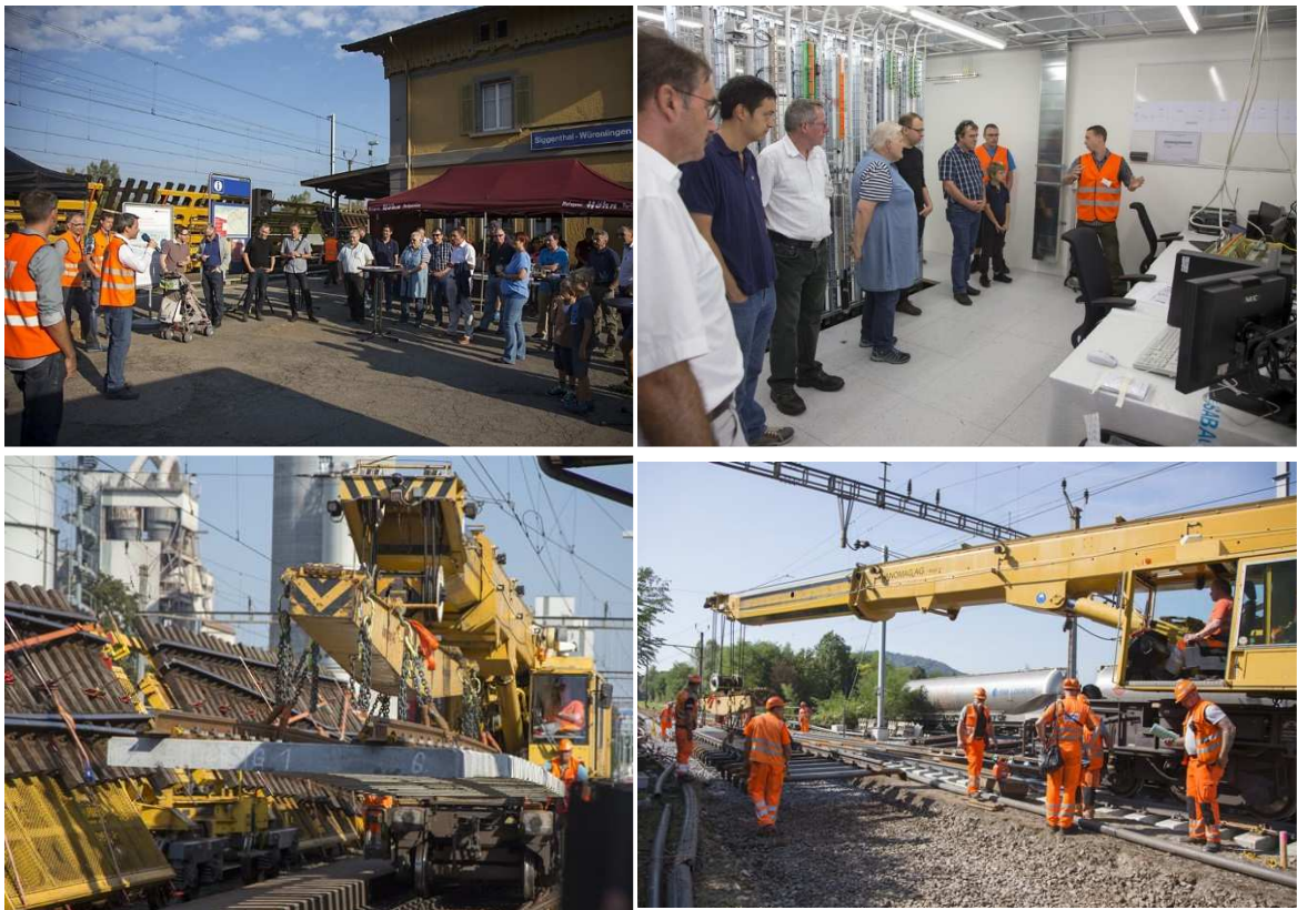
Bilder: (ol) Begrüssung durch R. Marti SBB; (or) Stellwerkraum, 2.vl Y. Matscher 3.vl U. Schaffer; (ul) aktueller Gleisbau; (ur) Weicheneinbau
