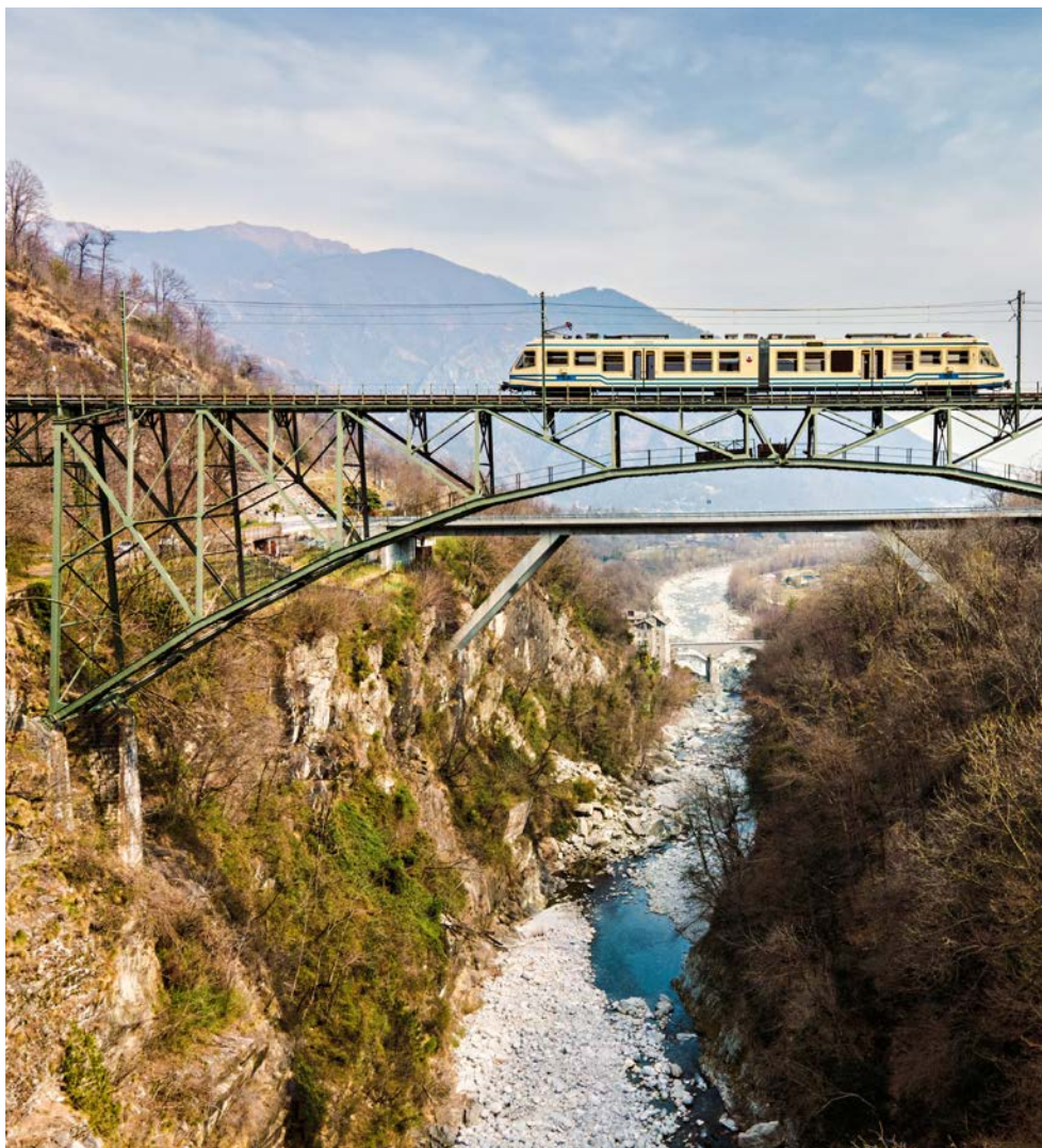
Centovalli-Bahn 80 Meter über Grund: Die Stahlbrücke über den Fluss Isorno bei Intragna als Meisterwerk der Ingenieurskunst Bilder: FART SA
