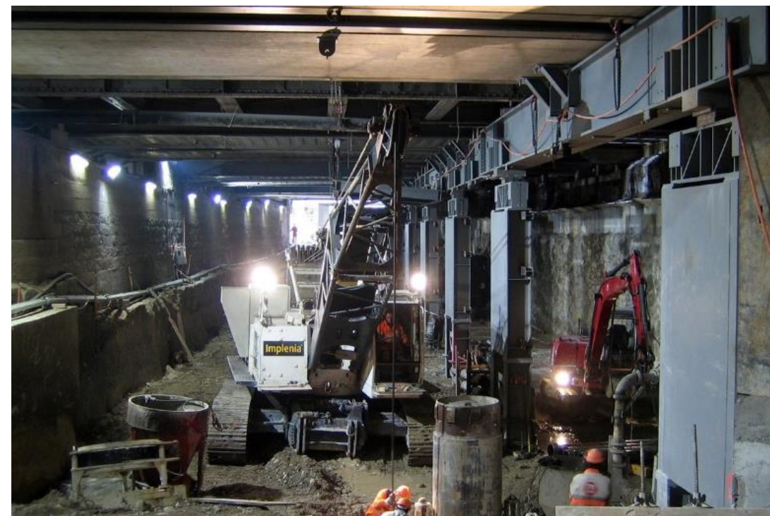
Beispiel: Bahnhof Löwenstrasse Zürich
